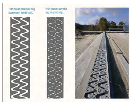
Figur 1. Bevægelig dilatationsfuge indsat i den nye Gudenåbro, oktober 2013. Fra Vejdirektoratets pjece: "Broer og tunneler".
