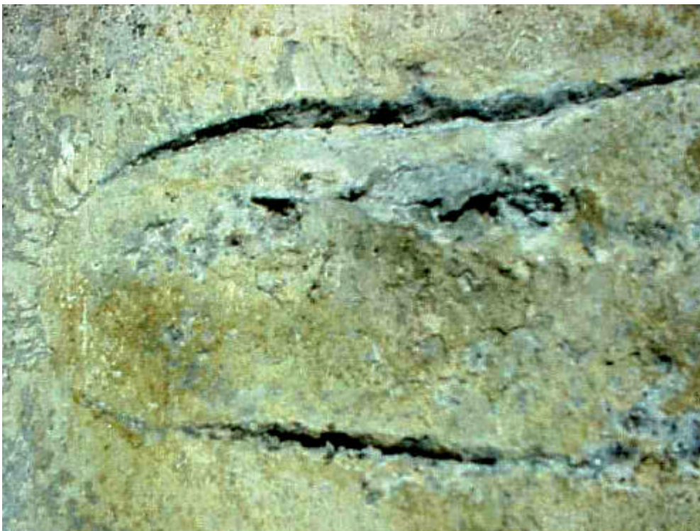
Figur 6.25 Oversigtsbillede af den lokaliserede og selektive korrosion på en longitudinal med et påsvejst knæ Korrosionens dybde er fra ca. 3 mm og til gennemtæring.
