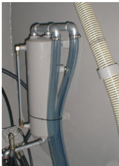
Figur 4.34 Billede af dræntank i slangetromlerum.
