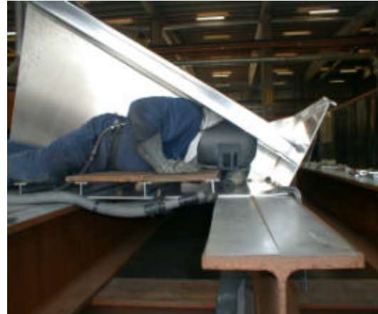
Figur 2.159 De snævre adgangsforskelde forhindrer svejseren i at komme i den rette synsvinkel til svejsningen, da der ikke er plads til hjelmen.
