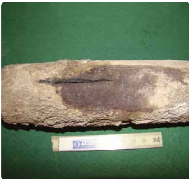
Krybebrud i overhederør
