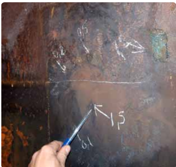
Efter fjernelse af korrosionsbelægninger vurderes form og dybde af korrosionsangreb
