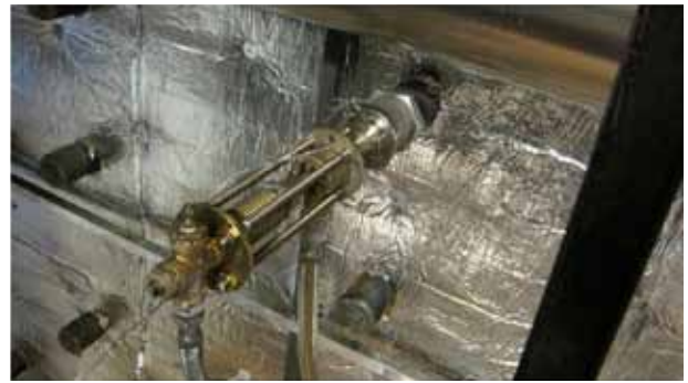
Korrosionssonde indsat i kedel
