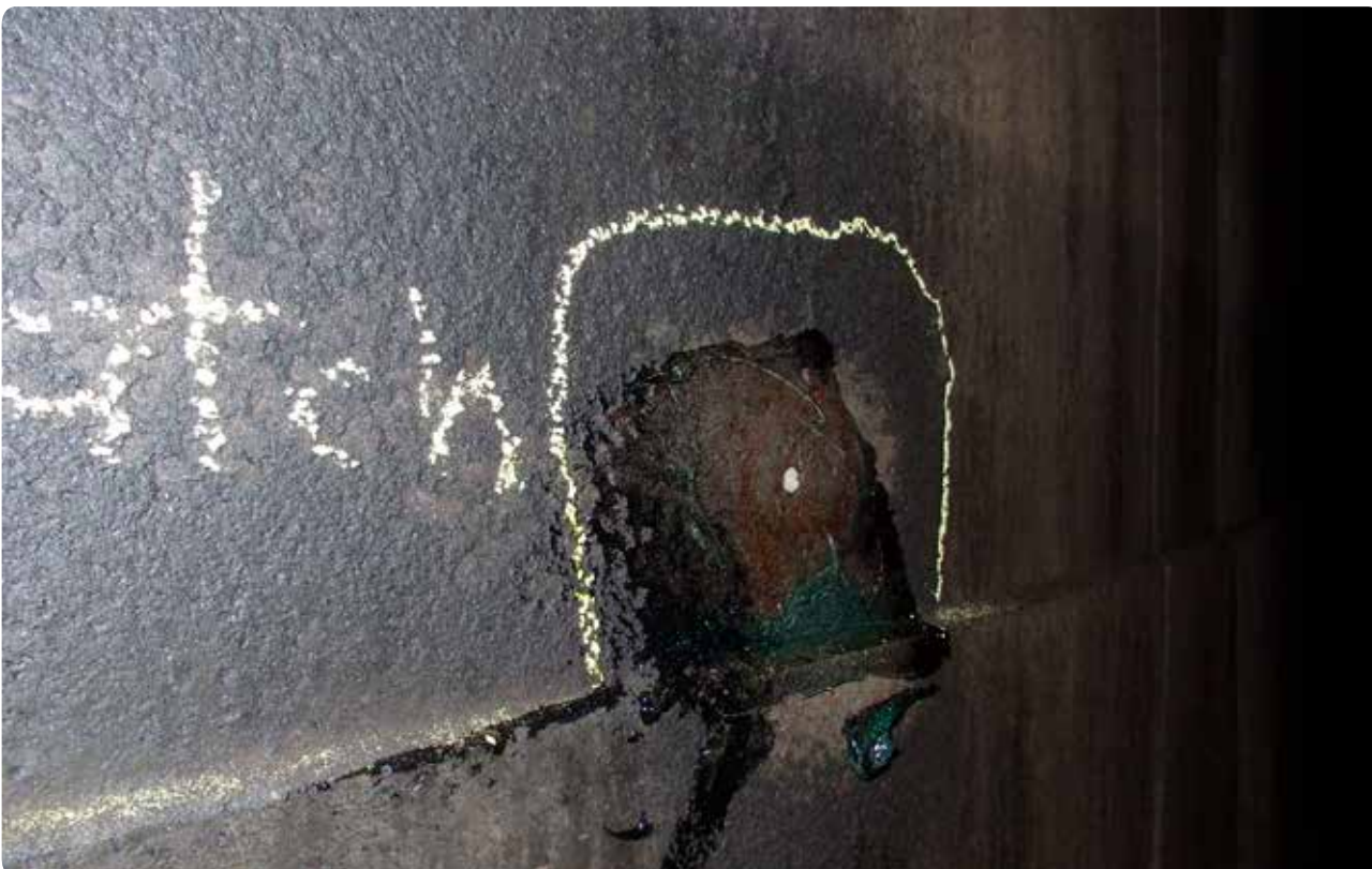
Opmåling af område med kraftig korrosion på tanksvøb
