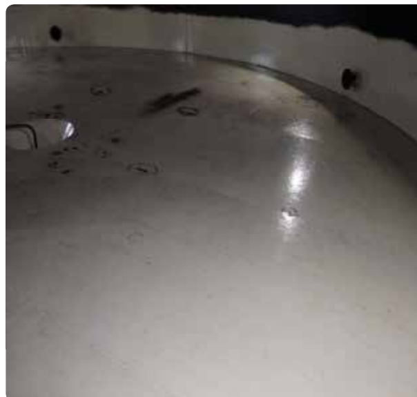
Tankbund med eksempel på opmærkning med undersidekorrosion efter endt screening af tankbunden
