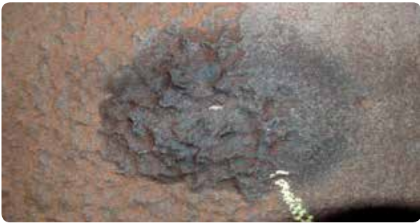
Eksempel på kraftig undersidekorrosion på tank (eksemplet er et stykke udskåret plade fra en tankbund)
