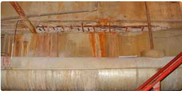
Kraftig korrosion på bærende bjælke i procesbygning forårsaget af lækager i kølesystem indeholdende saltvand
