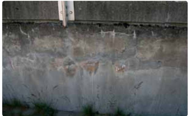
Revner med hvide udfældninger og korrosionsprodukter i bassin-væg indeholdende spildevand
