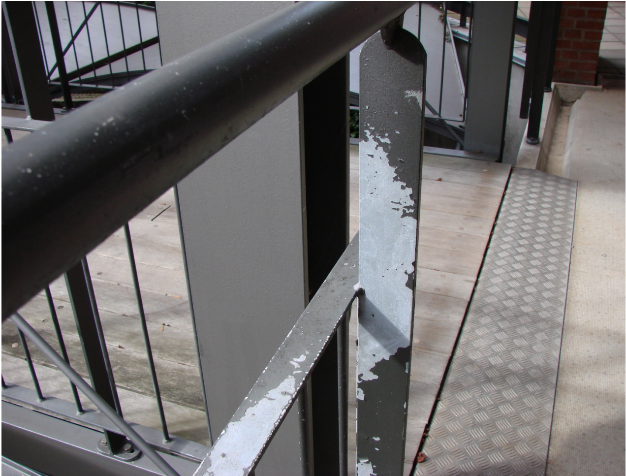
Fig. 2 København, oktober 2010. Et år gammelt Duplex-system er ødelagt. Omkostning til renovering anslået > 50.000 kr. Bemærk det store lodrette H-profil tv, som er i god stand – det er ikke varmforzinket, men er i stedet sandblæst og grundmalet før slutstrygning.
