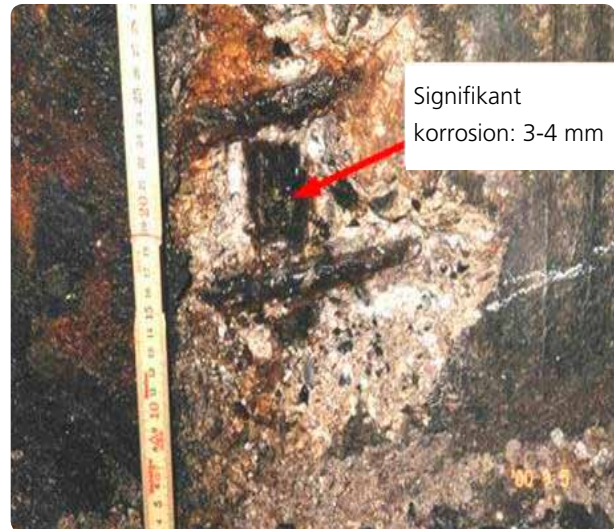
Exempel på exponerad korroderad armering
